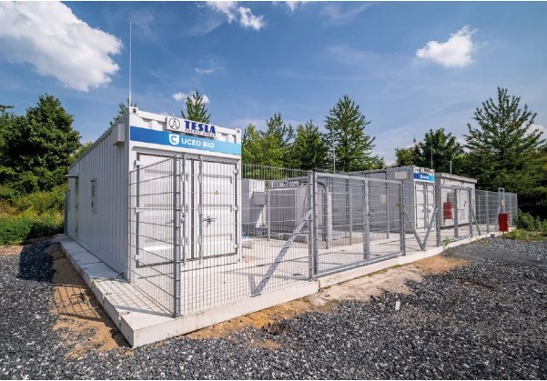
Velkokapacitní bateriové úložiště v Kutné hoře
