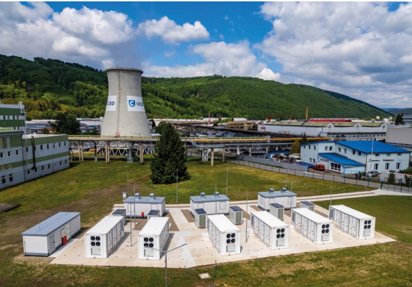
Tepláren Považská Bystrica
